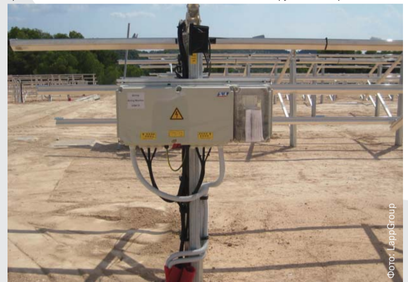
Инвертор солнечного парка в Бовере (Испания)
